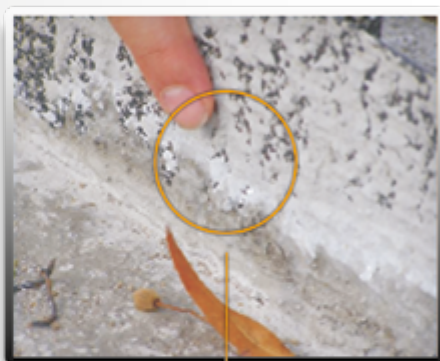
CEMflex VB widoczna krystalizacja
