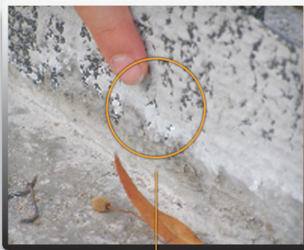
Fugenblech VB visible crystallisation
